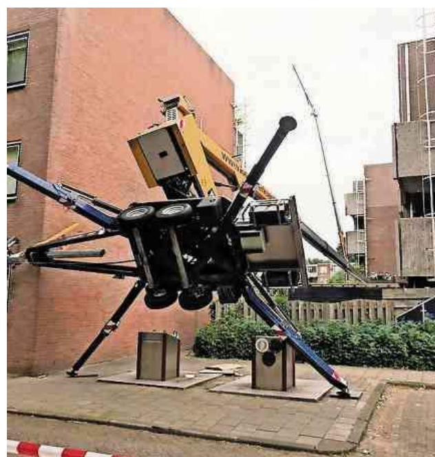
De hoogwerker is precies tussen de huizen door gevallen, in de tuin van Hans de Jong.
